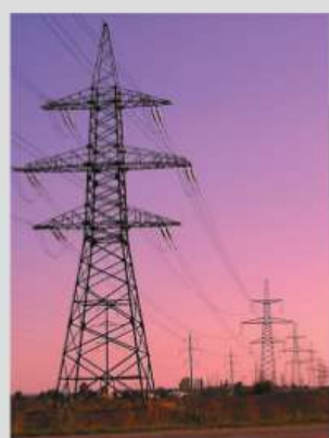
Современные высоковольтные ЛЭП
